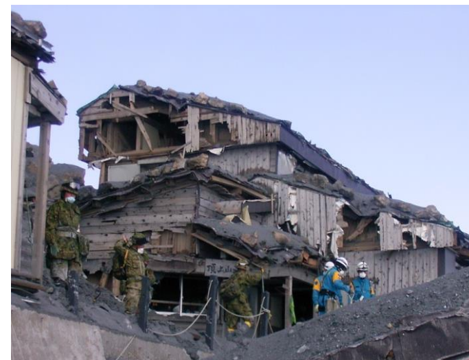
剣ヶ峰山荘は、噴石により屋根や壁に大きな穴が複数開いている。
